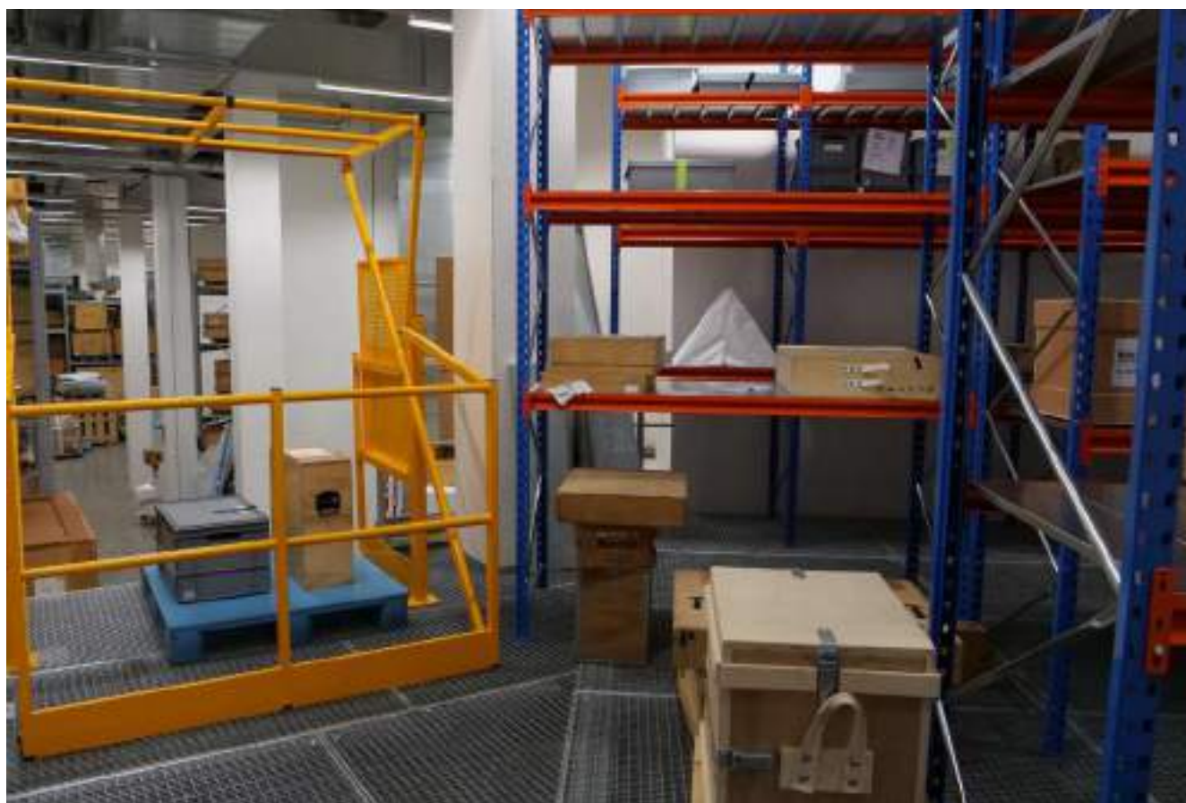
Barrière écluse pour la sécurisation de l'accès à la mezzanine.
